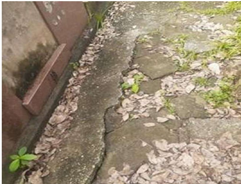
Figura 6. Rachaduras em uma das ruas do cemitério. Fonte: elaborado pelos autores.
